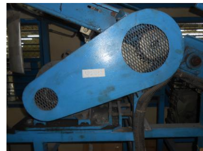
Gambar 3.9 Sambungan Gear Box dengan Conveyor Belt
