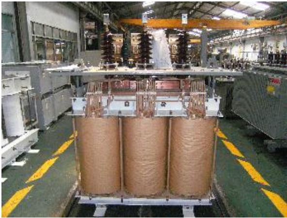
Gambar 2.1: Transformator sebelum di masukkan kedalam tanki
