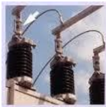
Lightning Arrester dan Posisi Penempatan pada Saluran Transmisi
