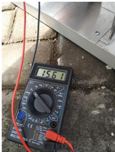
Foto pengukuran tegangan pada solar panel 100 wp
