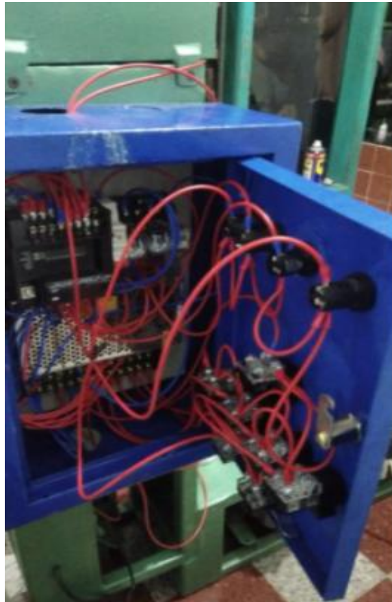
Gambar 7 Bagian Dalam Hardware Control Panel Mesin Wrapping
