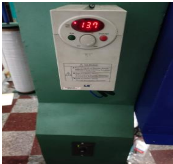
Gambar 12 Inverter pada Mesin Wrapping barang pada Palet berbasis PLC Omron
