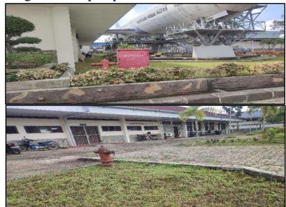
Gambar 8. Hydrant pada area kampus
