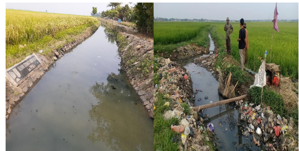
Gambar 4.8 Kondisi Bangunan dan Hambatan Jaringan Irigasi Desa Gunung Sari
